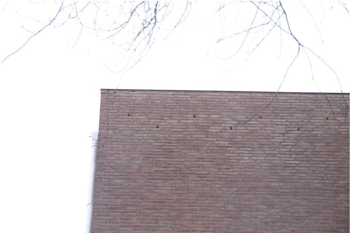
Foto 6: Er zijn aan weerszijden van het gebouw open stootvoegen aanwezig die dienst kunnen doen als toegang tot achterliggende spouwmuur voor vleermuizen, waardoor gebouwbewonende vleermuissoorten vaste rust- en verblijfplaatsen kunnen hebben.
